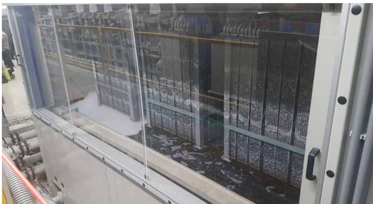
Obr. 3 – Stanice na rozpouštění zinku
